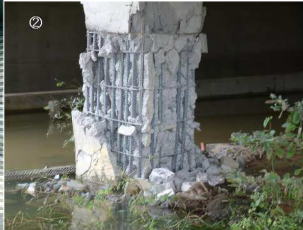
•付着割裂破壊
